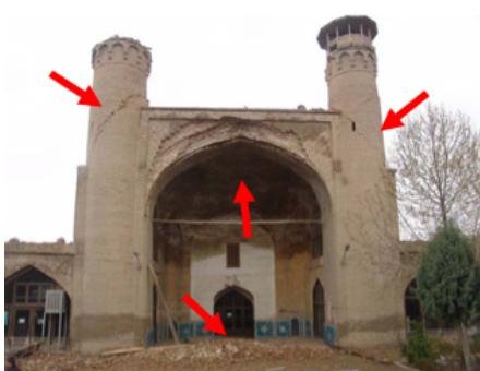
تصویر ۵: مسجد جامع بروجرد (بعد زلزله)
