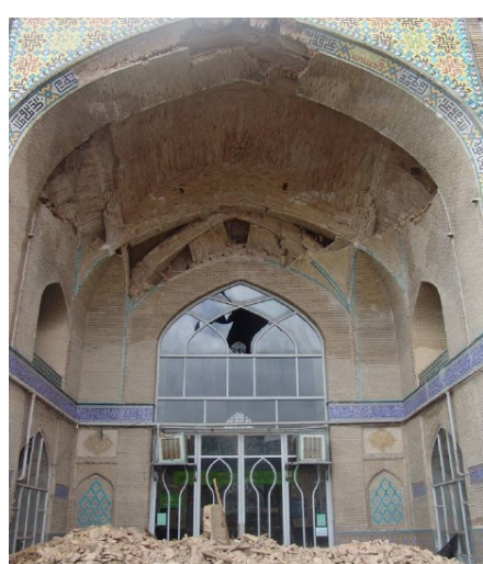
تصویر ۷: مسجد سلطانیه بروجرد (بعد زلزله)
