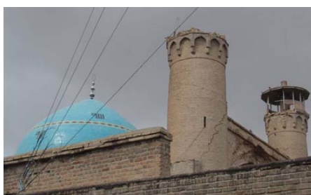
تصویر ۴: مسجد جامع بروجرد (بعد زلزله)
